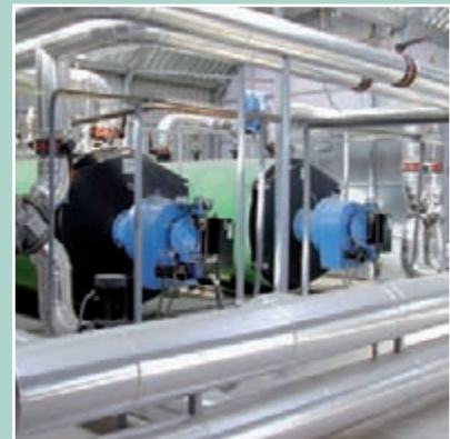
calefacción y aporte de CO 2 heating and CO 2 enrichment
