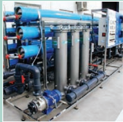
desaladoras desalination plants
