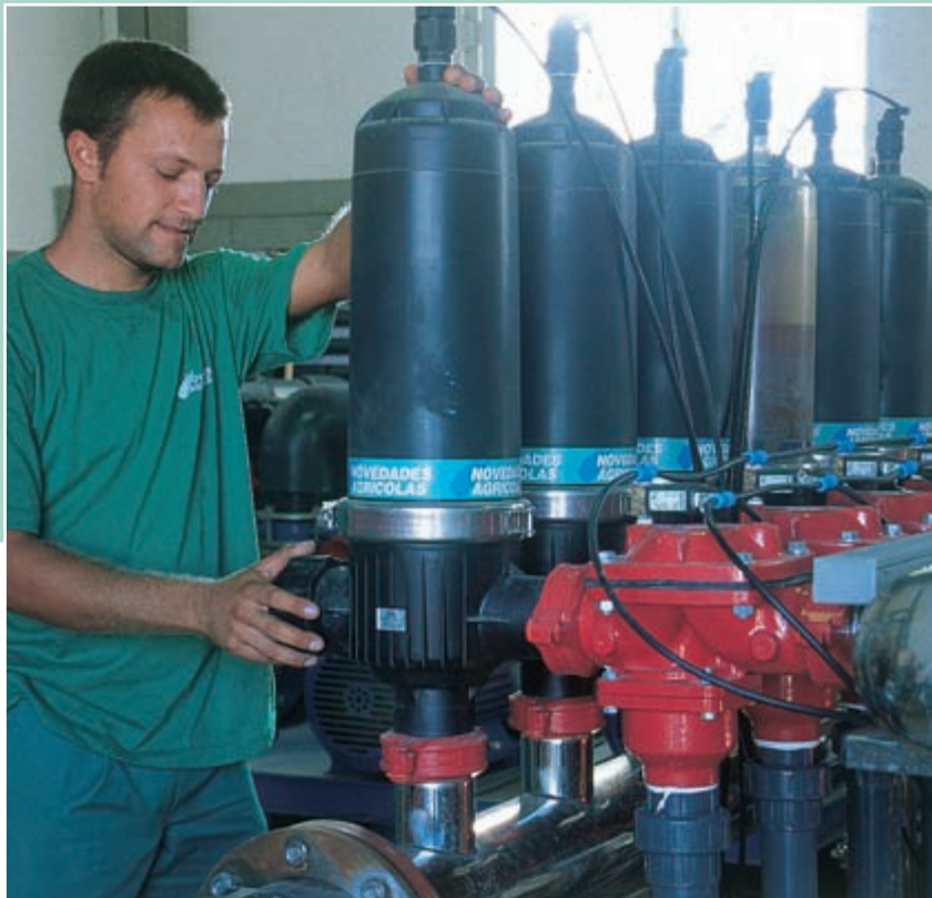
equipos de filtrado filtration systems
